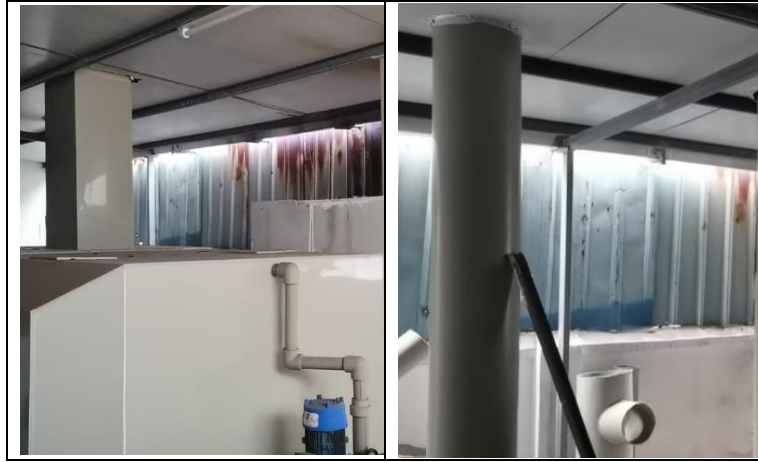
图 2-10 项目废气设施及排放筒现状图
