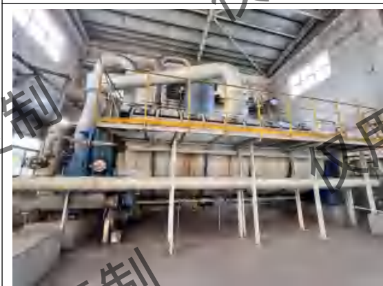
湿污泥干化车间
