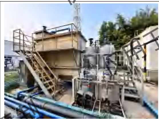
生活污水生化处理系统
