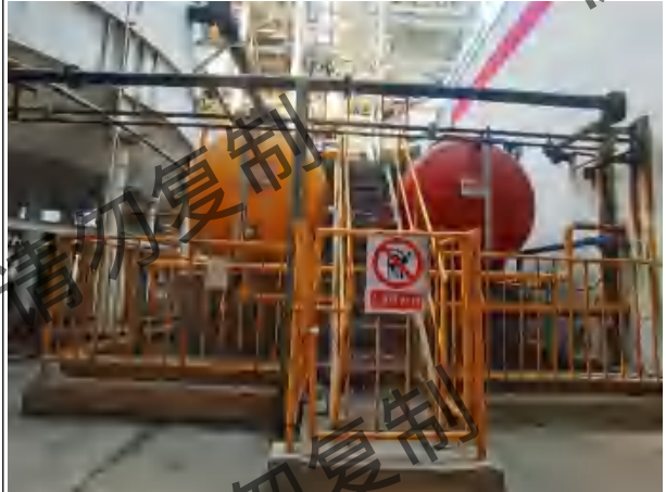
精处理酸碱储罐
