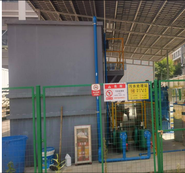
自建生产废水处理站
