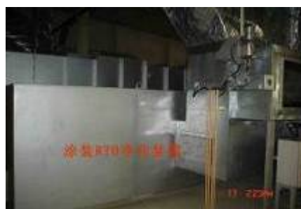
RTO 燃烧装置
