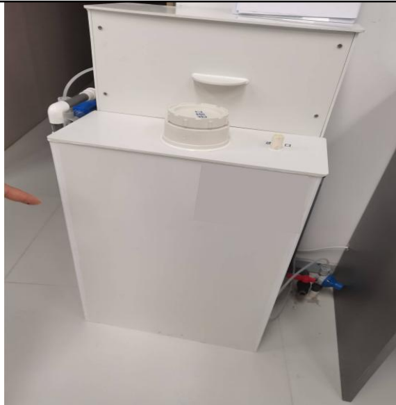
图 2-4 医疗废水处理设施照片
