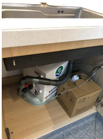
图 2-5 污水处理设施照片
