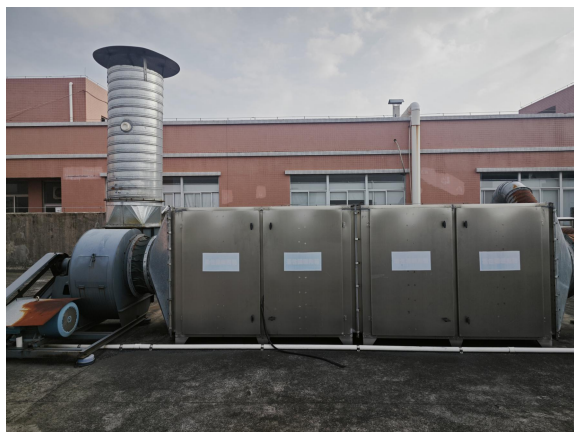
三车间一二级活性炭装置
