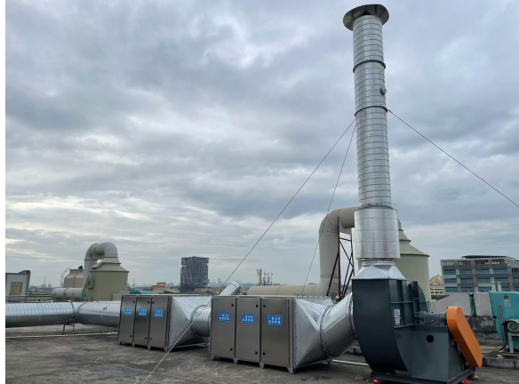
二车间一二级活性炭装置（本扩建项目）
