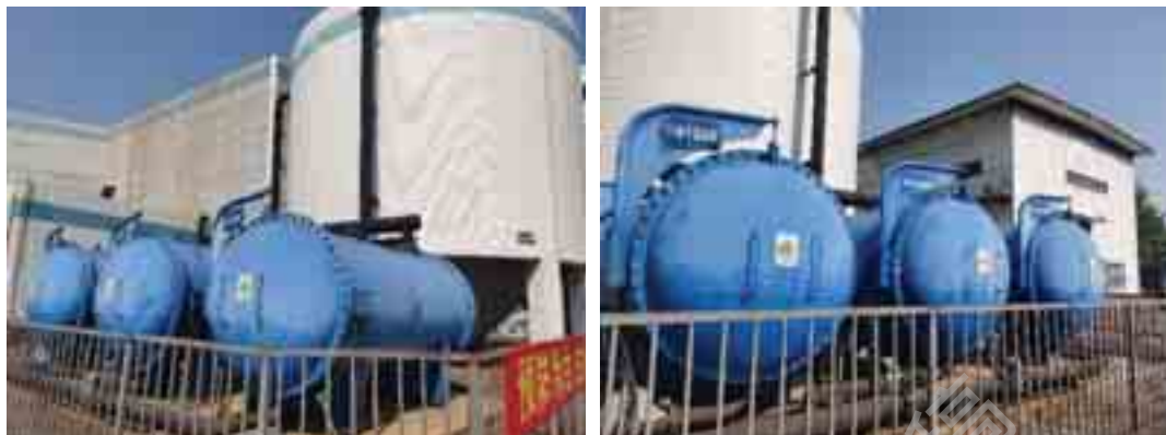
图 8.2-5 含煤废水处理系统现状照片
