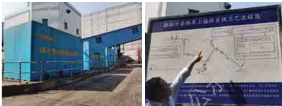
图 8.2-3 含油废水处理站现状照片
