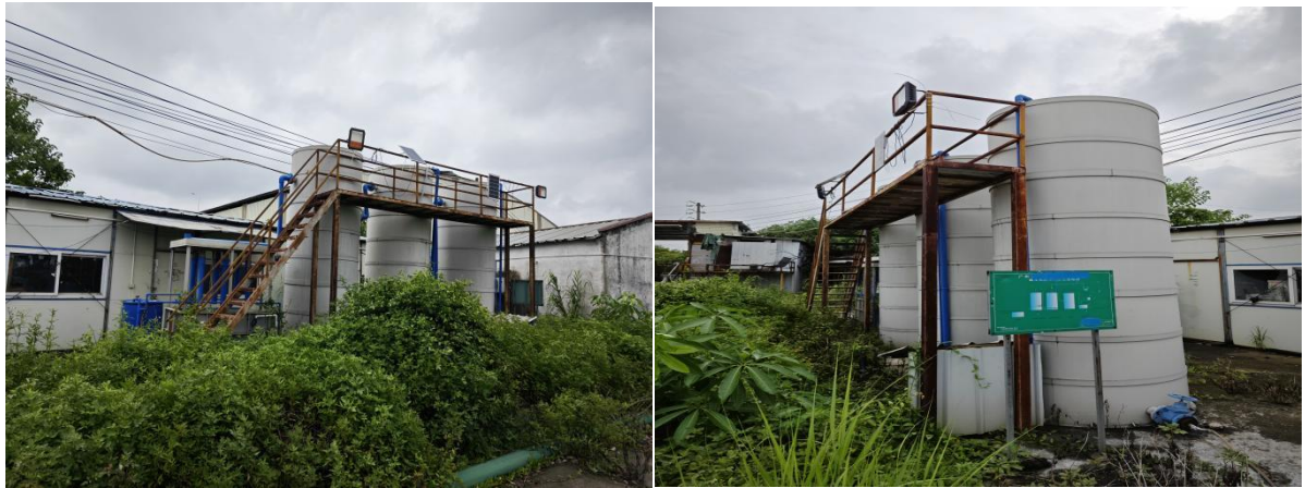
图 5-2 自建生活污水处理站照片图
