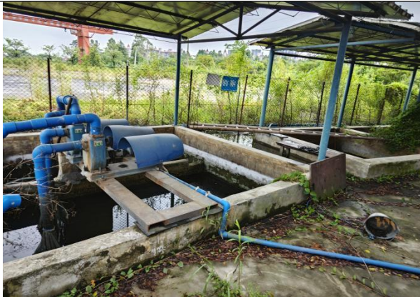
项目雨水三级过滤池
