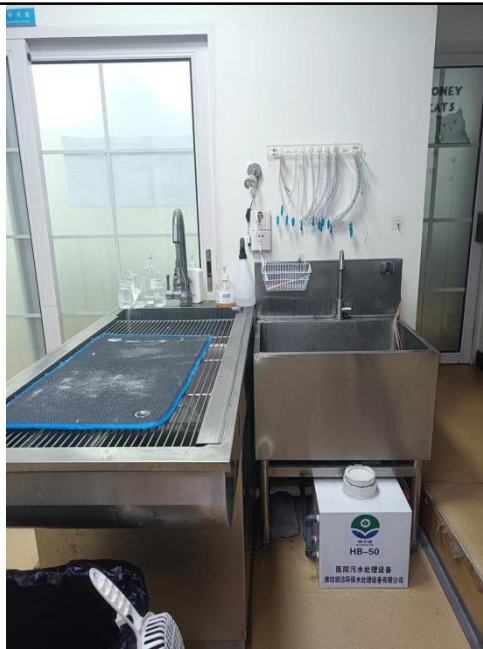
图 2-5 污水处理设施照片（位于二楼手术室旁）
