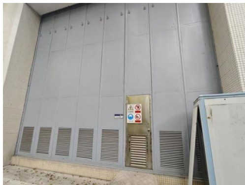
本期拟扩建#3 主变预留位置
