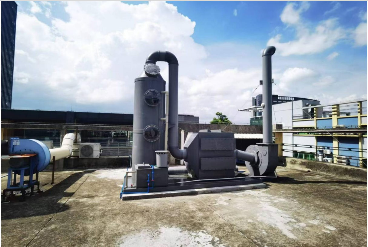
已建的“碱液喷淋（设除雾装置）+活性炭吸附”装置
