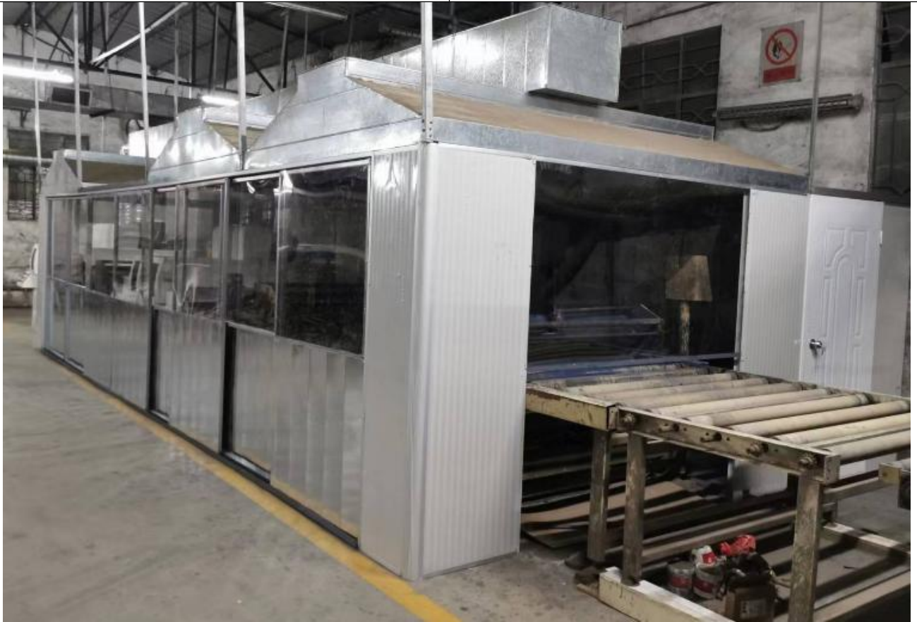
废气收集区域整改现状
