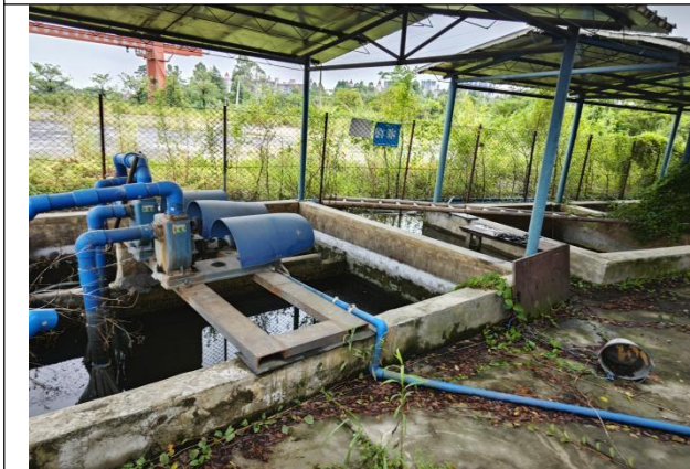
项目雨水三级过滤池
