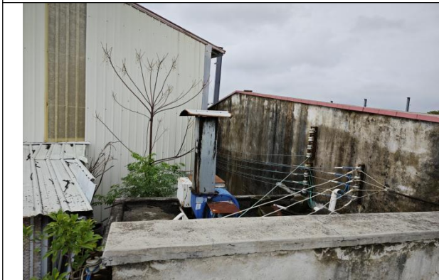
项目油烟排放烟道
