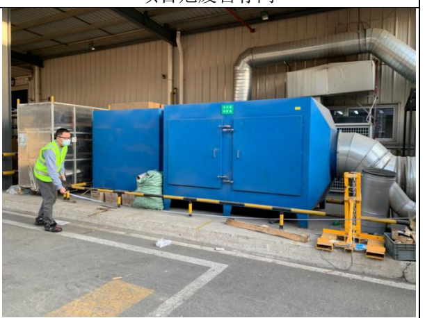
项目废气治理设施
