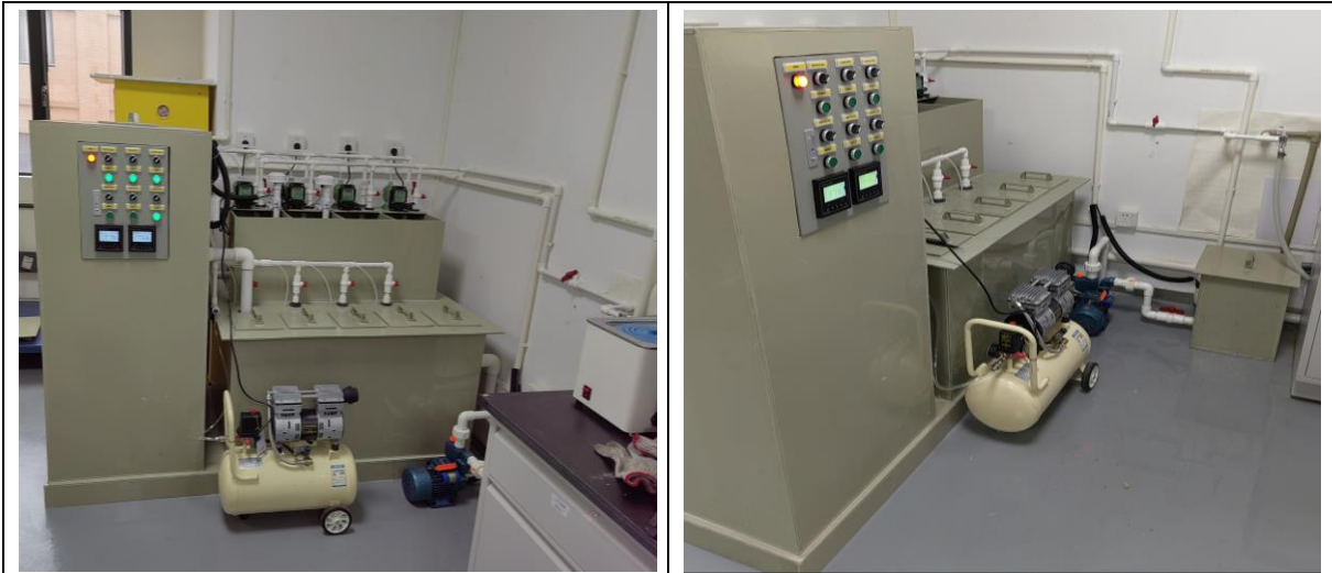
废水处理设施
