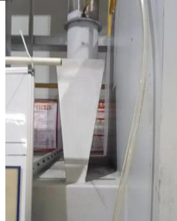
2#钎焊炉废气收集口 1
