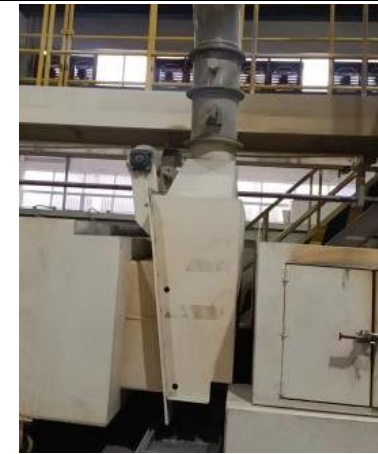
2#钎焊炉废气收集口 2
