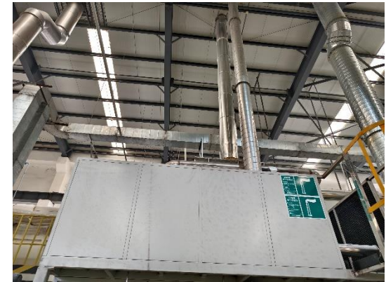
FQ-85970-04\FQ-85970-08 废气排气筒标识牌
