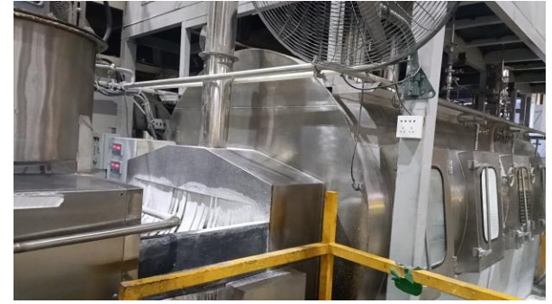
2#钎焊炉配套预喷钎机-出口
