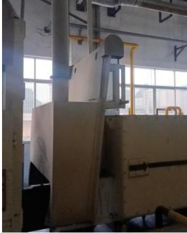
1#钎焊炉废气收集口
