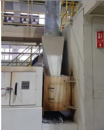
2#钎焊炉配套烘干炉废气收集口
