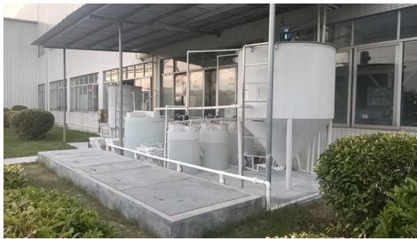
废水处理设施
