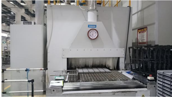
2#钎焊炉配套脱脂炉-进口
