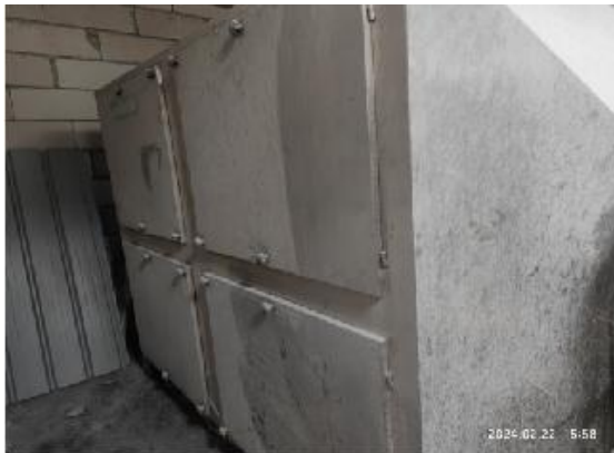
活性炭吸附装置箱照片
