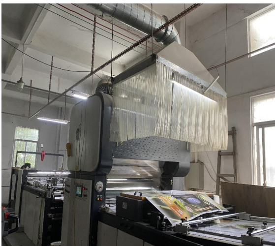
废气收集装置 2
