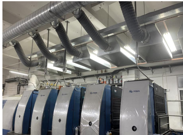
废气收集装置 1
