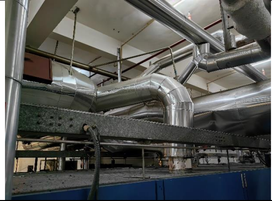
定型机废气收集管道 1
