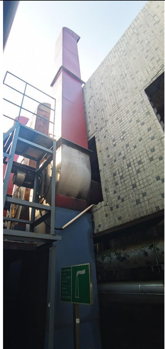
定型废气排放口 (1#)
