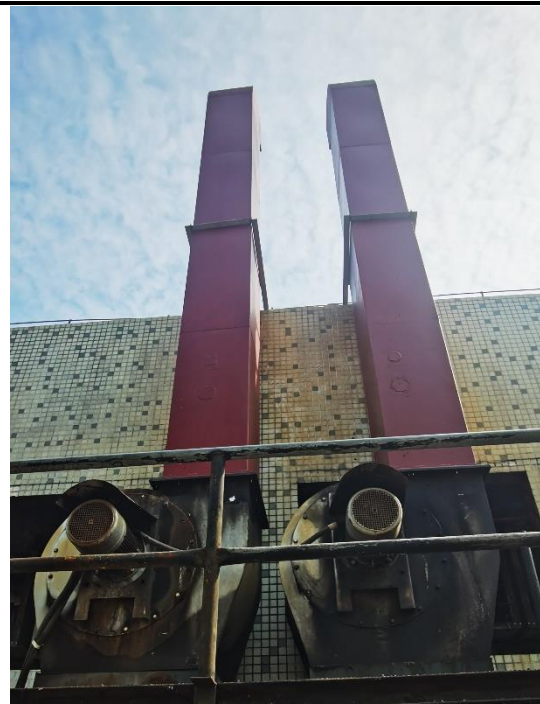
定型废气排放口（3#、4#）
