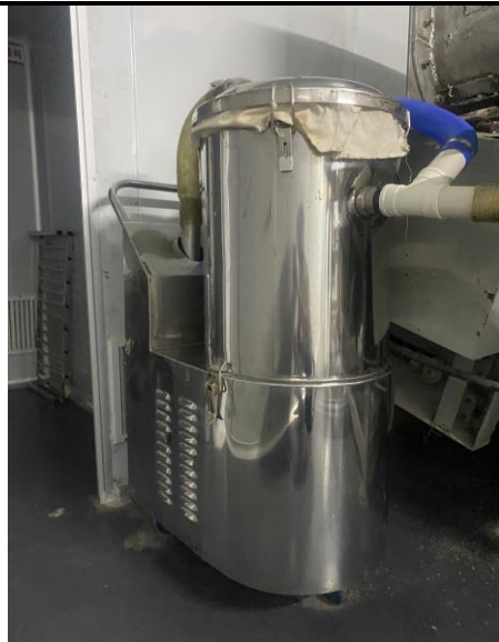
投料缸配套的布袋除尘器
