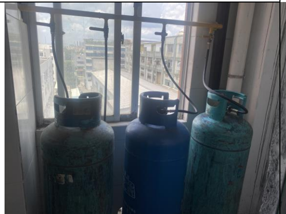
液化石油气储气罐
