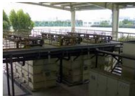
回用水站过滤池
